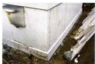
Die wenigen Aussparungen und der Sockelbereich werden auf der Baustelle mit exakt zugeschnittenen Elementen gedämmt.
